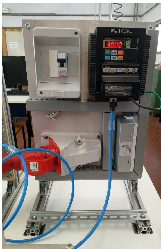
Quadro elettrico “Inverter”
